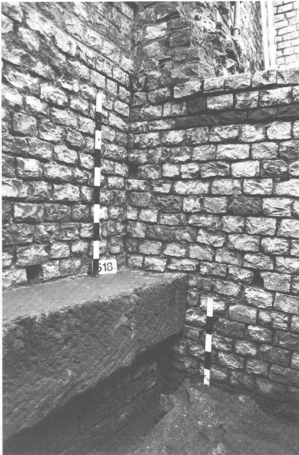
Abb. 14: Augst, Theatersanierung (Grabung 2000.55). Umfassung im Bereich des Stützpfilers MR 194. Blick von Osten. Rechts die Umfassungsmauer MR 58, links der später angebaute Stützpfiler MR 194. In der Mauer- schale von MR 58 ist die beim Anbau des Stützpfilers entstandene Fuge erkennbar (vgl. Abb. 13).
