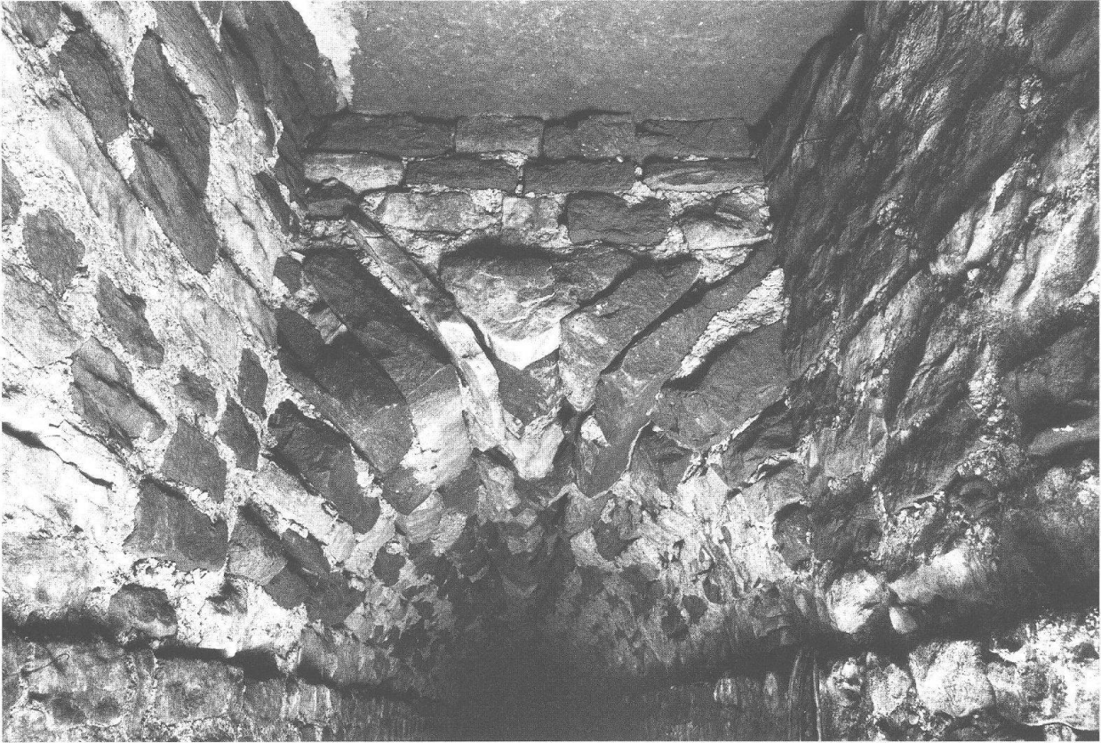
Abb. 3: Augst, Theatersanierung (Grabung 2000.55). Nordabschnitt des Abwasserkanals. Blick in den Einstiegschacht des älteren Gewölbeabschnitts. Der Aufbau des Gewölbes aus radial gestellten Sandsteinquadern und einem Schlussstein von dreieckiger Form ist sehr gut erkennbar. Am oberen Bildrand die originale Deckelplatte aus Buntsandstein.
