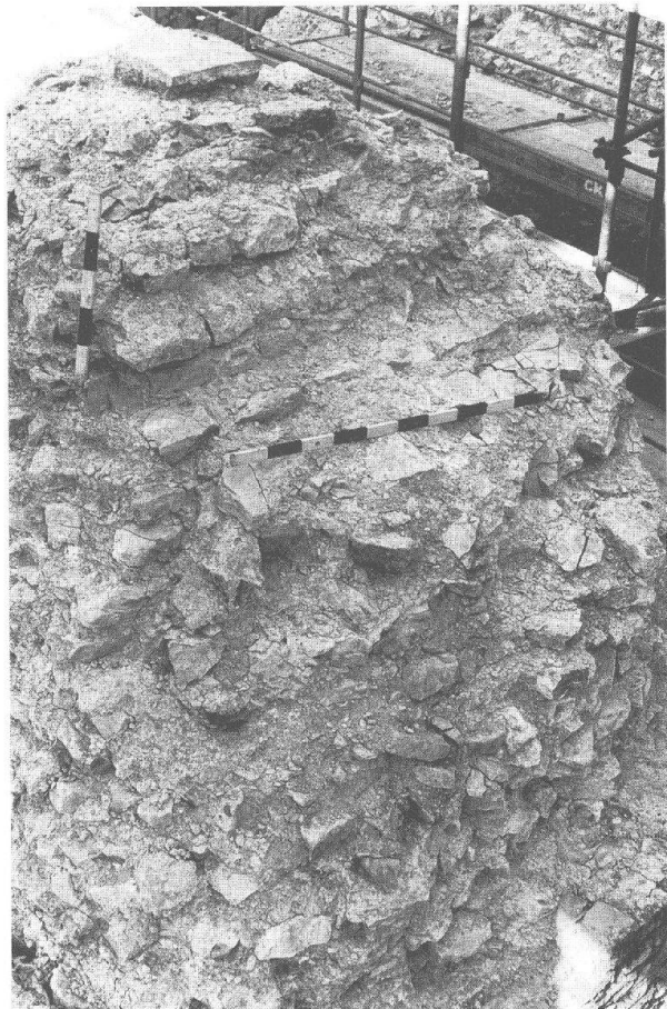
Abb. 4: Augst, Theatersanierung (Grabung 1998.55). Südaditus, westliche Bühnenmauer von Süden (MR 44). Nördliches Fenstergewände mit getreppt verlaufendem Widerlager des Fenstergewölbes. Vor dem unteren Teil der Abmauerung, wo der Massstab liegt, ist der Rest des Bettungskeiles für das Gewölbeauflager zu erkennen.
