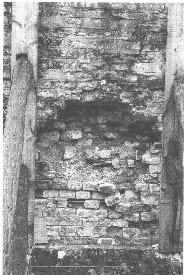
Abb. 37: Augst, Theatersanierung (Grabung 1994.55). Südaditus. Ausbruch in der westlichen Mauerschale (Erstrestaurierung 1907) der äusseren Bühnenmauer 44. Ein typischer Frostschaden.
