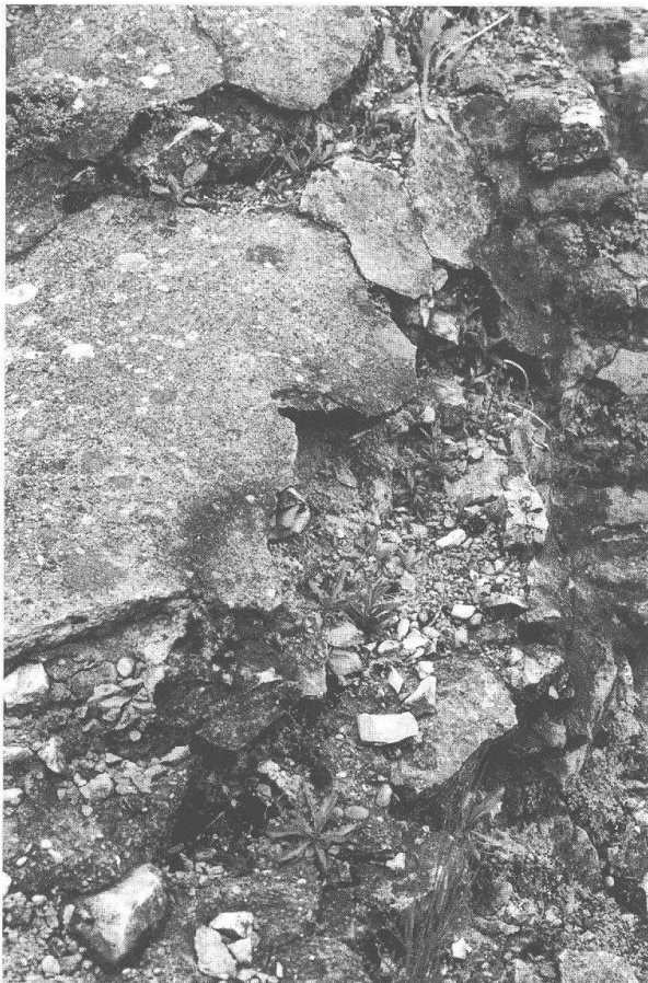
Abb. 36: Augst, Theatersanierung (Grabung 1994.55). Südaditus. Starke Frostschäden an der äusseren Bühnenmauer 44. Detail der Mauerkrone mit aufgebrochener und abgelöster Zementabdeckung von ca. 1907.
