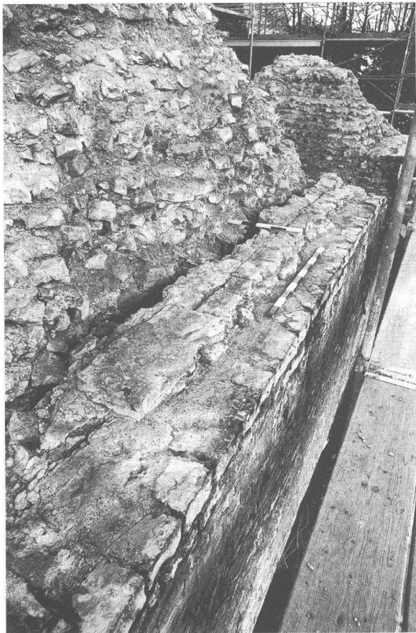
Abb. 3: Augst, Theatersanierung (Grabung 1998.55). Südaditus, westliche Bühnenmauer (MR 44). Antik reparierte Vormauerung mit Ziegelschrottmörtel als Bindemittel und eingesetztem, zweilagigem Ziegelband. Im Zentrum der breite Spalt mit dem dahinterliegenden älteren Kernmauerwerk.
