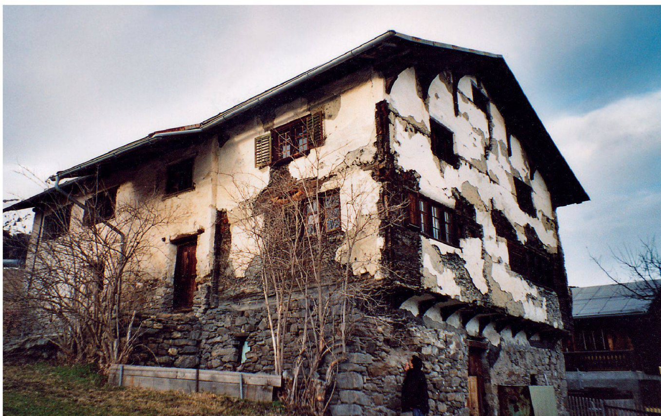
Das Gebäude in Vella (GR), dessen Grundmauern auf das 15. Jahrhundert zurückgehen, zeigte sich 2003 schon vor dem illegalen Abbruch verlottert.
