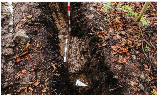
Abb. 15: Windisch-Scheuergasse 2018 (V.018.3). Enge Verhältnisse im Leitungsgraben: Unmittelbar unter dem durchwurzelten Humus erscheint die Krone einer oberflächlich freigelegten römischen Mauer; links und rechts davon liegt eine gelbe Lehmplanie abgerissener Fachwerkbauten des Legionslagers.
