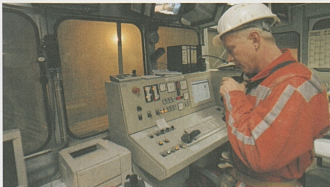
Die gigantische Förderanlage für Mensch, Maschine und Gestein wird von einem Kommandoraum aus überwacht.
