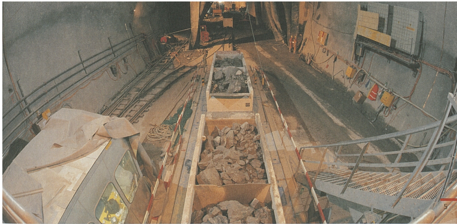
Insgesamt werden in den Förderwagen 3,7 Millionen Tonnen Material vom Schachtfuss auf das Niveau des Zugangstollens transportiert.
