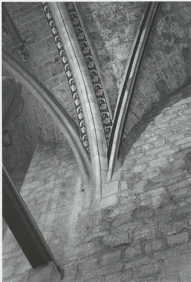
Fig. 466. Notre-Dame-de-Romont. Un des culots du chœur à bouquet de feuilles en «fer de lance» et retombée des croisées d'ogives du milieu du mur nord, 1447–1451 (photo MG, 2012).
