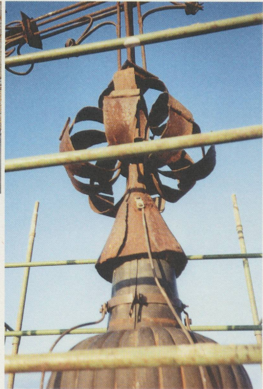
FIG. 166 — L'épi de faitage et la base de la croix de la flèche avant travaux
