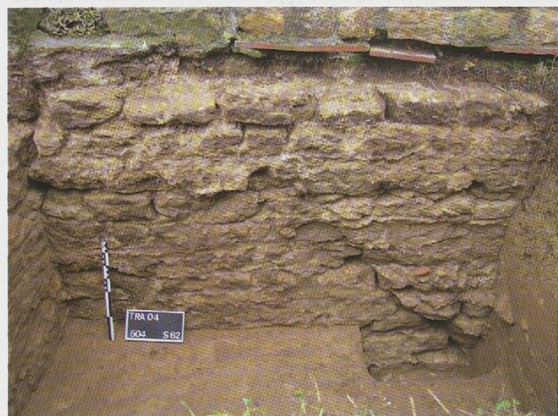
Abb. 172 S 62. Horizontalfuge in M 66 (spätantike Reparatur der Mauerchale). Blick von N.
