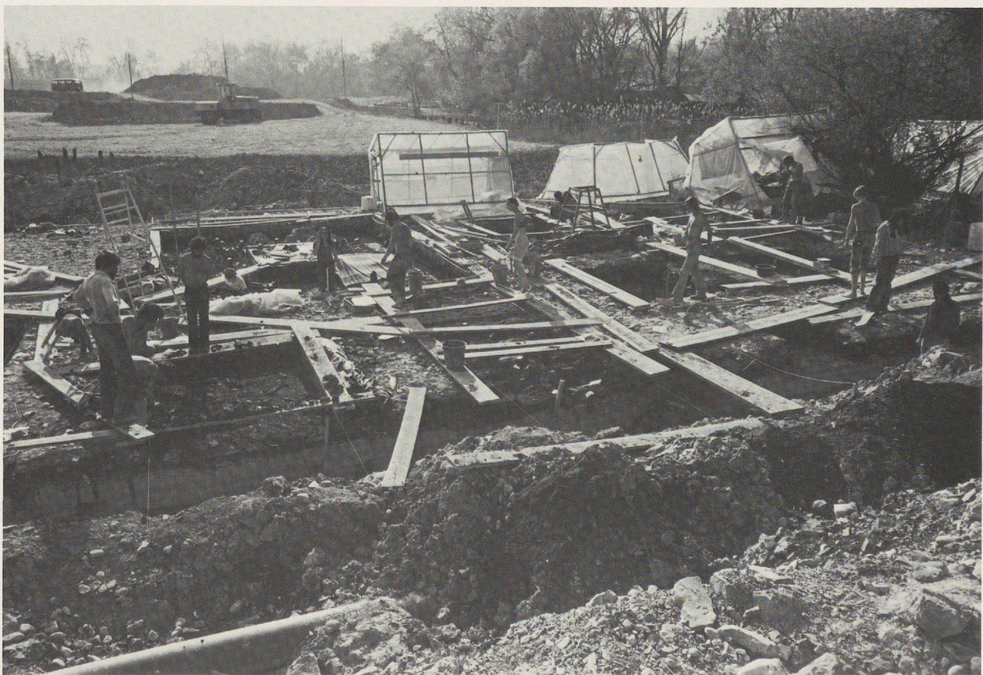
Fig. 4 Vue du chantier en activité, en avril 1974, zone est. Le lac est à gauche, le rivage à droite. Au fond, la zone ouest a déjà été remblayée. Entre deux, abris permettant de recouvrir un caisson de 3 x 2 m en cas de froid, de pluie ou de gel.
