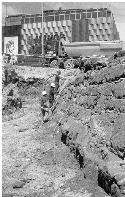
Fig. 6 Fribourg/Avenue de Tivoli – Grand-Places. Mur occidental de l'ouvrage à cornes en juin 2005
