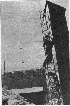
Eine ganze Transformationsstation musste errichtet werden, um die vielen elektrischen Maschinen mit Strom zu versorgen.
