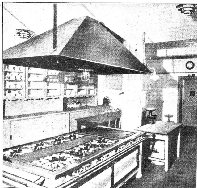
Künstliches Klima in der Küche! Die warme Luft wird durch den über dem Herd liegenden Schornstein abgesaugt; die Zuführung der künstlich vorbehandelten Luft erfolgt durch die an der Decke sichtbaren Apparate.
