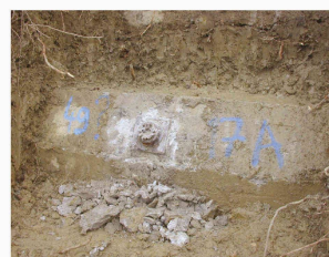
Tête d'ancrage délogée (Photo Bonnard&Gardel Ingénieurs-conseils SA)
