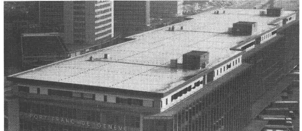
B488 Port-franc, Genève - Architecte: Koechlin René et Mozer Marc, Genève 7'000 m 2 fixés mécaniquement
