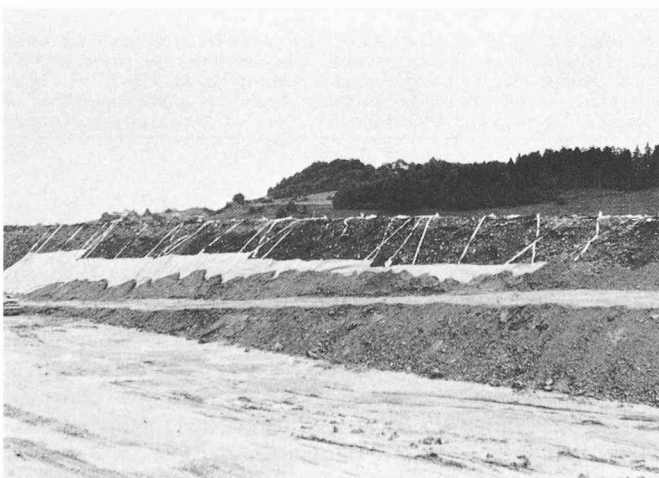
Fig. 9. — Vue sur le chantier du Breitfeld. On reconnaît une partie des feuilles d'étanchéité en Sarnafil FP qui sont remontées le long des talus et fixées grâce aux rubans enroulés pour faciliter la pose. En partie, les remblais sont déjà exécutés dans la zone horizontale ainsi que le long des talus. (Photo prise par l'auteur)
