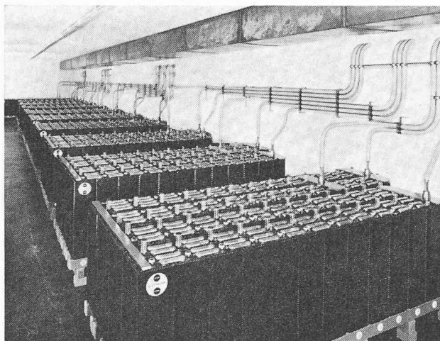
Fig. 3. — Exemple de réduction de volume dans un local, par l'emploi de batteries à plaques tubulaires, d'une capacité pourtant deux fois plus grande.
