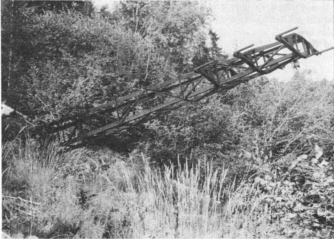
Fig. 3. — Pylône basculé par le glissement des Fontanelles.
