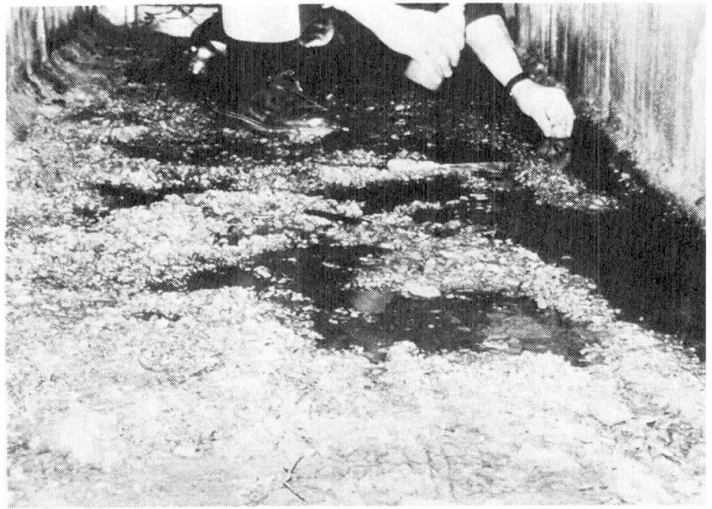
Fig. 8 Dégât de gel au plancher de caissons inaccessibles
