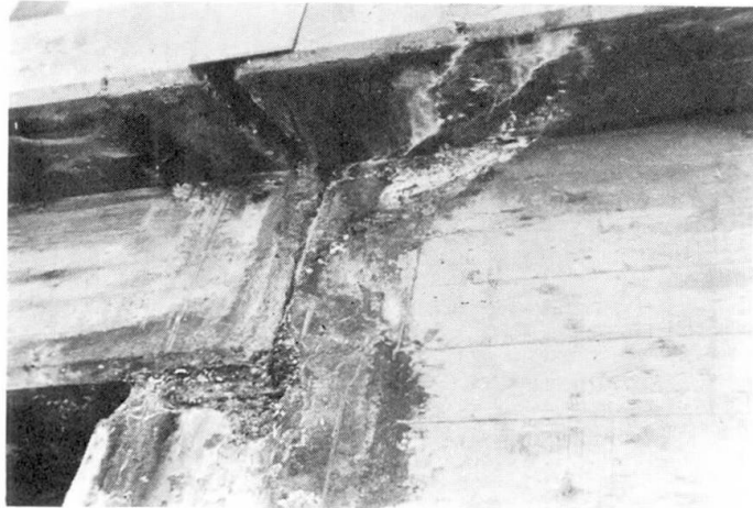
Fig. 2 Exemple de dégât de gel
