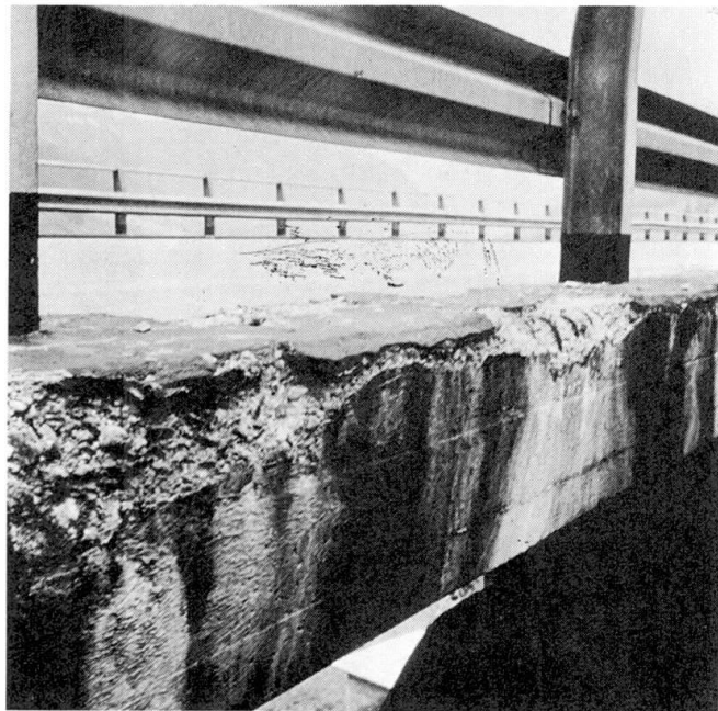
Fig. 7 Destruction de bordure de pont
