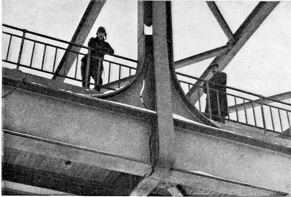
Fig. 2. Rupture dans une poutre, composée par soudure, constituant membrure inférieure, à la jonction avec une entretoise et avec un montant.
