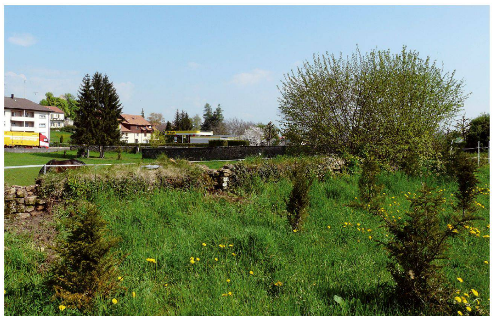
Fig. 15 2009.04. Mur des Sarrasins. Le mur est presque complètement recouvert de végétation.
