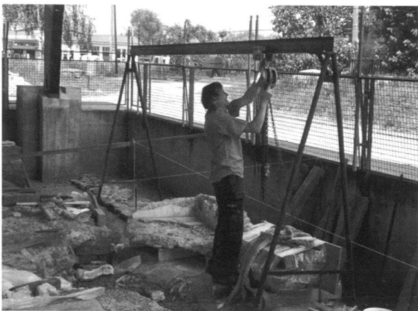
Fig. 3a. Les Thermes de Perruet. Remise en place des deux morceaux de l'angle du bassin sur des fondations modernes (photo MRA).
