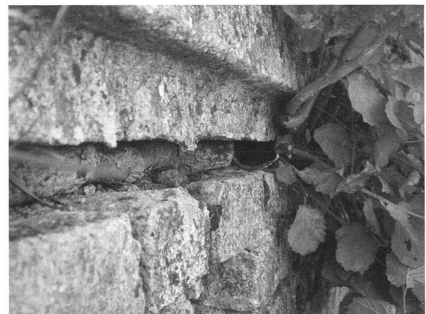
Fig. 11. Mur d'enceinte. Un exemple des dégâts causés par la croissance d'arbustes entre la dalle de couverture du mur et la maçonnerie de son parement (photo MRA).
