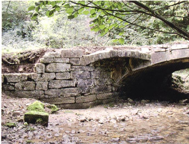
Abb. 5.2: Der bergseitige Seitenbogen vor der Sanierung.
