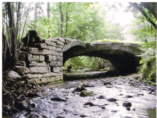
Abb. 5.1: Die Bütschenbrücke bei Reigoldswil vor der Sanierung.
