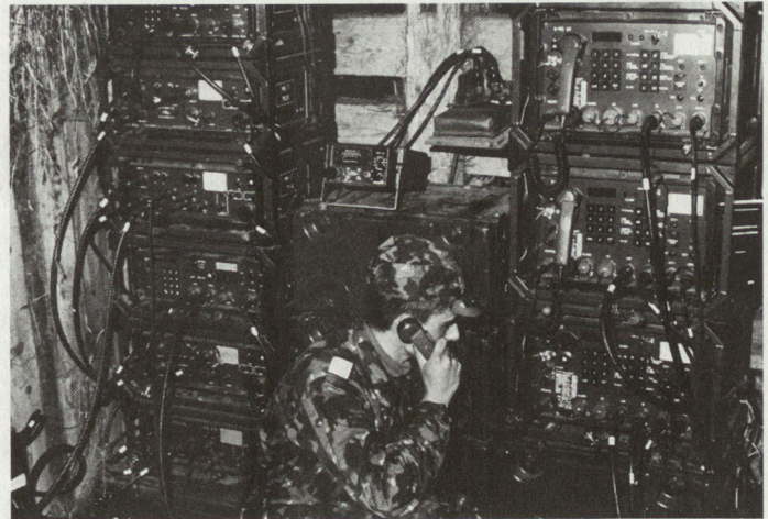
Bild 6. Richtstrahlübertragung im IMFS-90: Mehrere Telefonleitungen werden in der Mehrkanalausrüstung MK-7 (links oben) gesammelt, im Chiffrierzusatz CZ-1 (links unten) verschlüsselt und über die Bedieneinheiten an die Antenne(n) der Richtstrahlstation R-915 weitergeleitet. Hersteller MK-7: Hasler AG, Bern; CZ-1: BBC, Baden.
