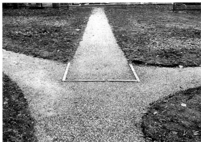
Aufbau der Wege: 15 cm Kofferung, rezyklierter Bauschutt; 4 cm Deckschicht, Strassenkies Spezial von Wimmis.
