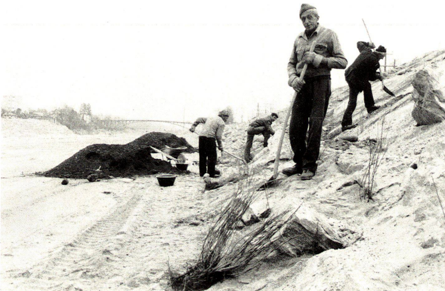
Forstarbeiter bei den Pflanzarbeiten am «argine insommergibile». Die Fugen wurden mit «Lita» ausgefüllt, die Pflanzlöcher mit Lochseisen vorbereitet und mit Humus angereichert.
