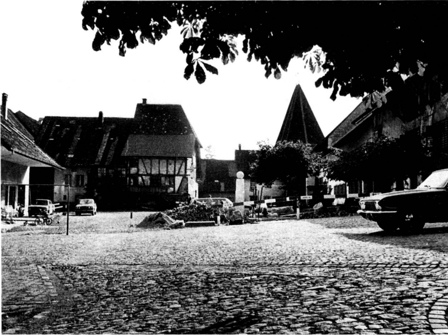
Blick über eine schon ausgeführte Pflasterung (aus den im nahen Städtchen Wangen an der Aare verschmähten alten Steinen!) in Richtung Wehrturm. In der Baustelle auf der Bildmitte ist die Säule des Brunnens sichtbar, bis zu dem ein offener Bach fließt. Bild: Hans Graf
