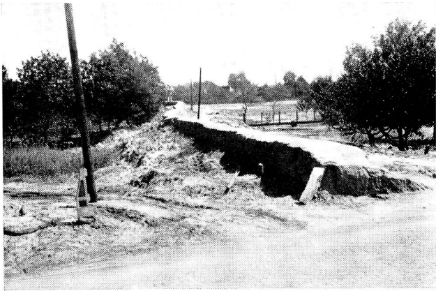
Einen Kilometer vor dem ungarischen Städtchen Győr, im Zentrum des Ueberschwemmungsgebietes, haben die Bewohner in aller Eile und bei steigendem Wasser einen Damm errichtet,
