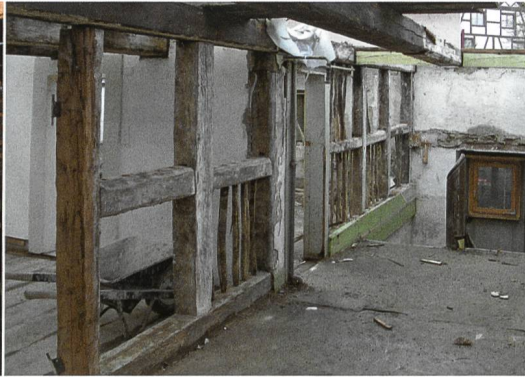
Oberwil, Hauptstrasse 36, interne Wand im Erdgeschoss und ersten Obergeschoss. Sie trennte den Gang von den anschliessenden Kammern. Datierung 18. Jahrhundert.
