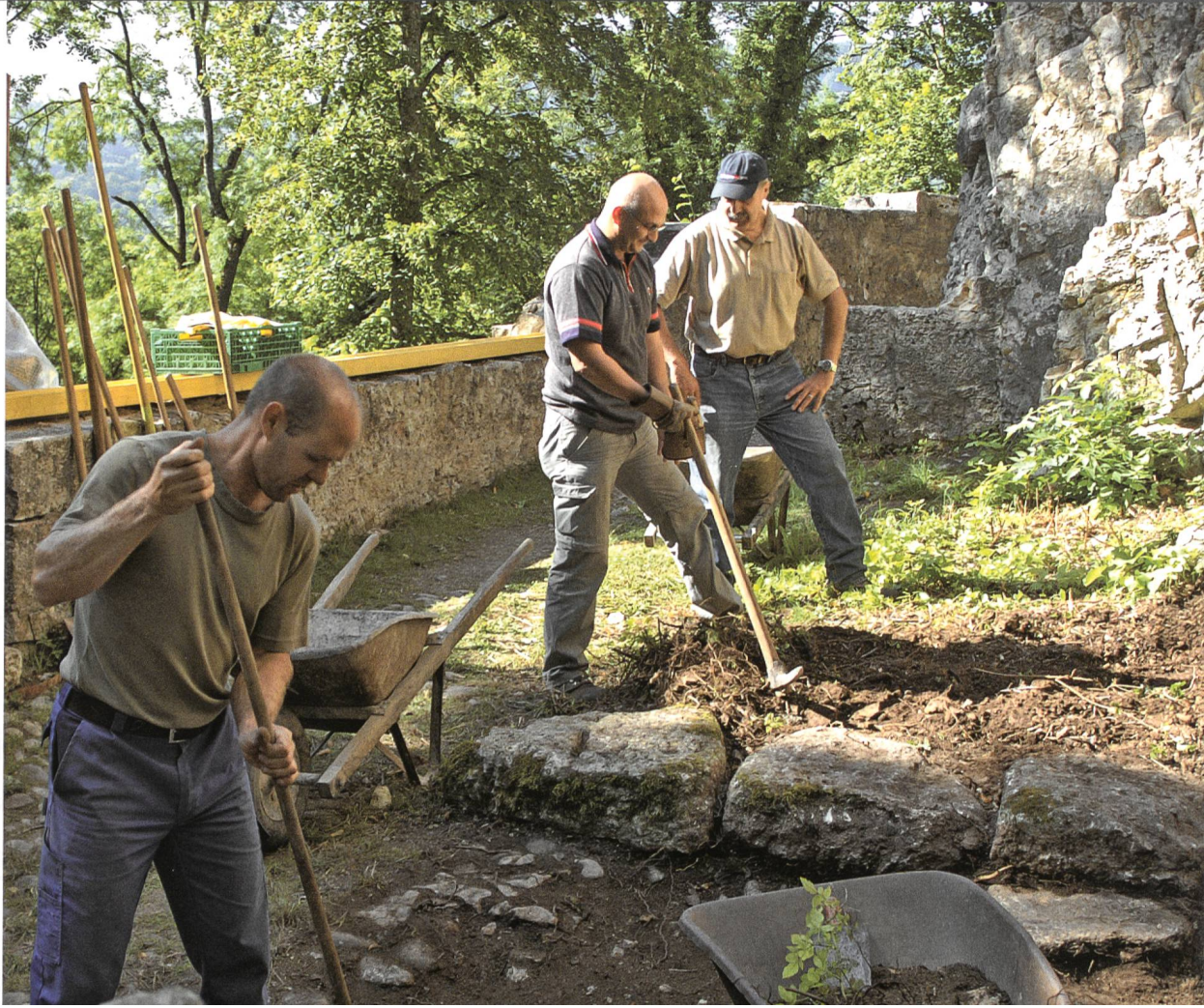
Löffelfingen, Homburg. Mitarbeiter der Stiftung Öko- Job legen die überwachsenen Mauern frei.
