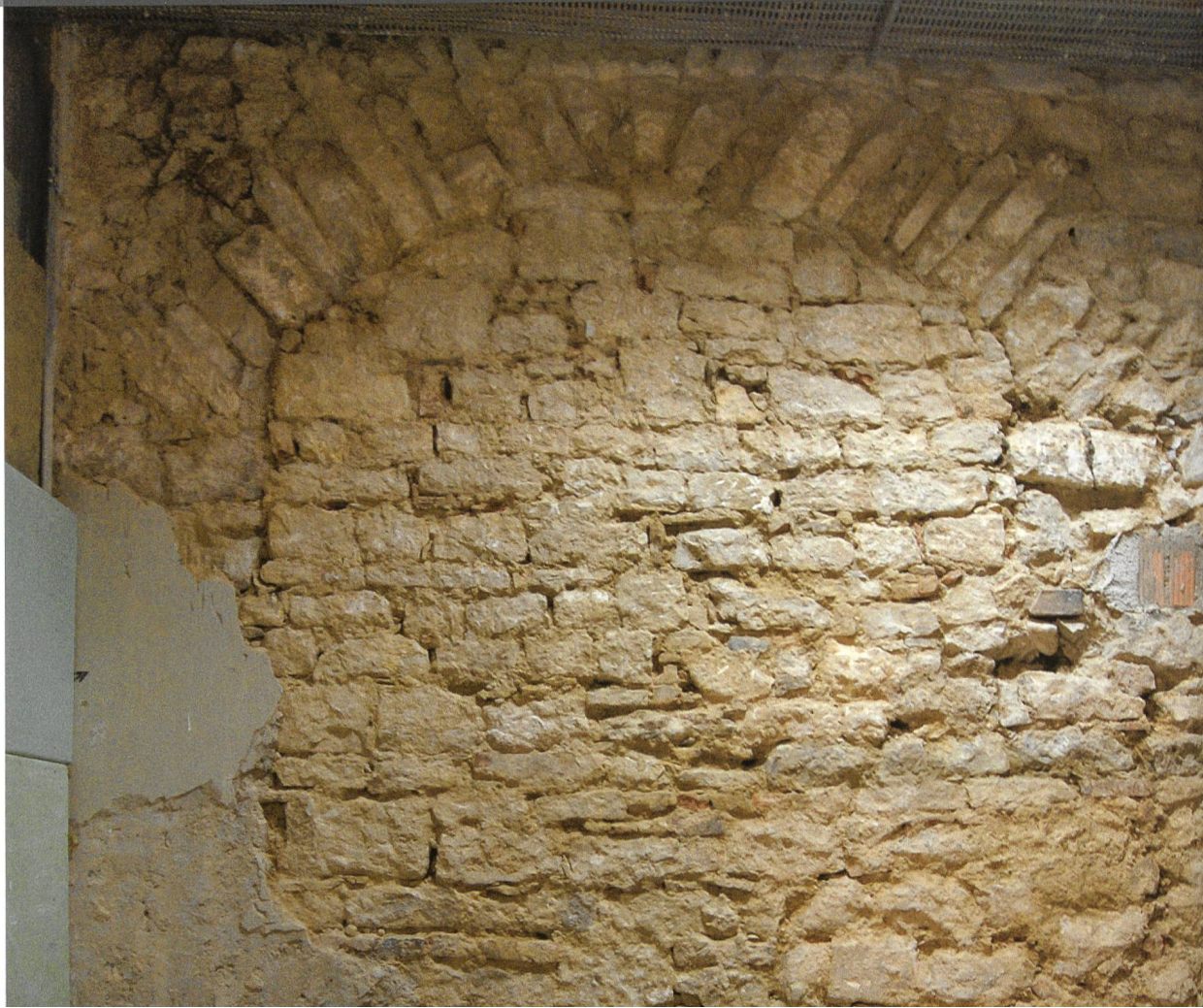
Liestal, Regierungsgebäude. Ansicht der Aussen- seite der vermauerten Toröffnung mit Blick vom Anbau in Richtung Südwesten.
