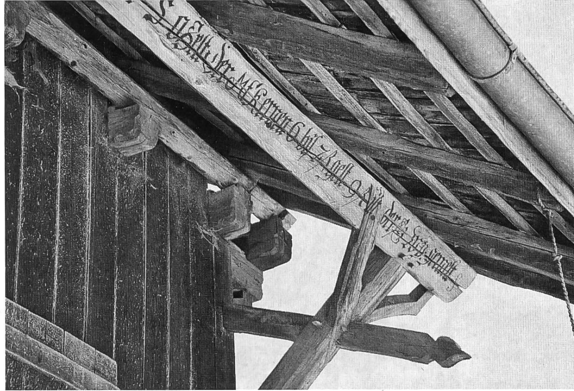
Abb. 1: Vordachpfette der Scheune Hans Roellistrasse 27 in Scheuren, Gemeinde Maur. Foto: A. Kümin. Die Vordachpfette, welche das über die Hauswand hinausragende Dach trägt, wird durch schräg verlaufende Balken an der Hauswand abgestützt und durch Zugbänder mit der Fassade verbunden. Letztere enden oft mit einer Verzierung. Die ganze Inschrift lautet: «Der Bau ruht in Gottes Hand. er wol in behüeten vor Wasser und Brand. Er Lass jm auch befallen sein. Dass Jenig so wird kommen dryn. Es hat sy gebauen Hs. Heinrich Hofmann. Zimbermann Mr. Hs. Rudolf Frey jm Radrey. da mann 1750 Zelt. Der Mt Kernen 6 bis 7 R (Gulden) gelt. 9 R ist der E (Eimer) Wy gemelt.»
