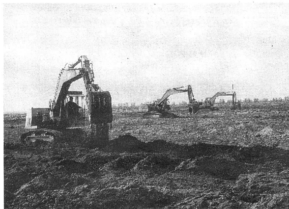
Baggerarbeiten in der Nekropole von Salapia, angeblich zur Anlage von Entwässerungsgräben. Das Gelände ist denkmalgeschützt, Baggerarbeiten sind verboten.
