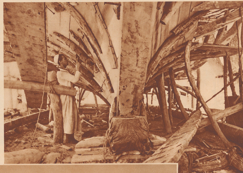
Arabische Boot im ersten Baustadium. Schon zeichnet sich der Rumpf des Dreihundert-Tonnen-Seglers ab. Die Innenwand des Schiffes wird verschalt.
