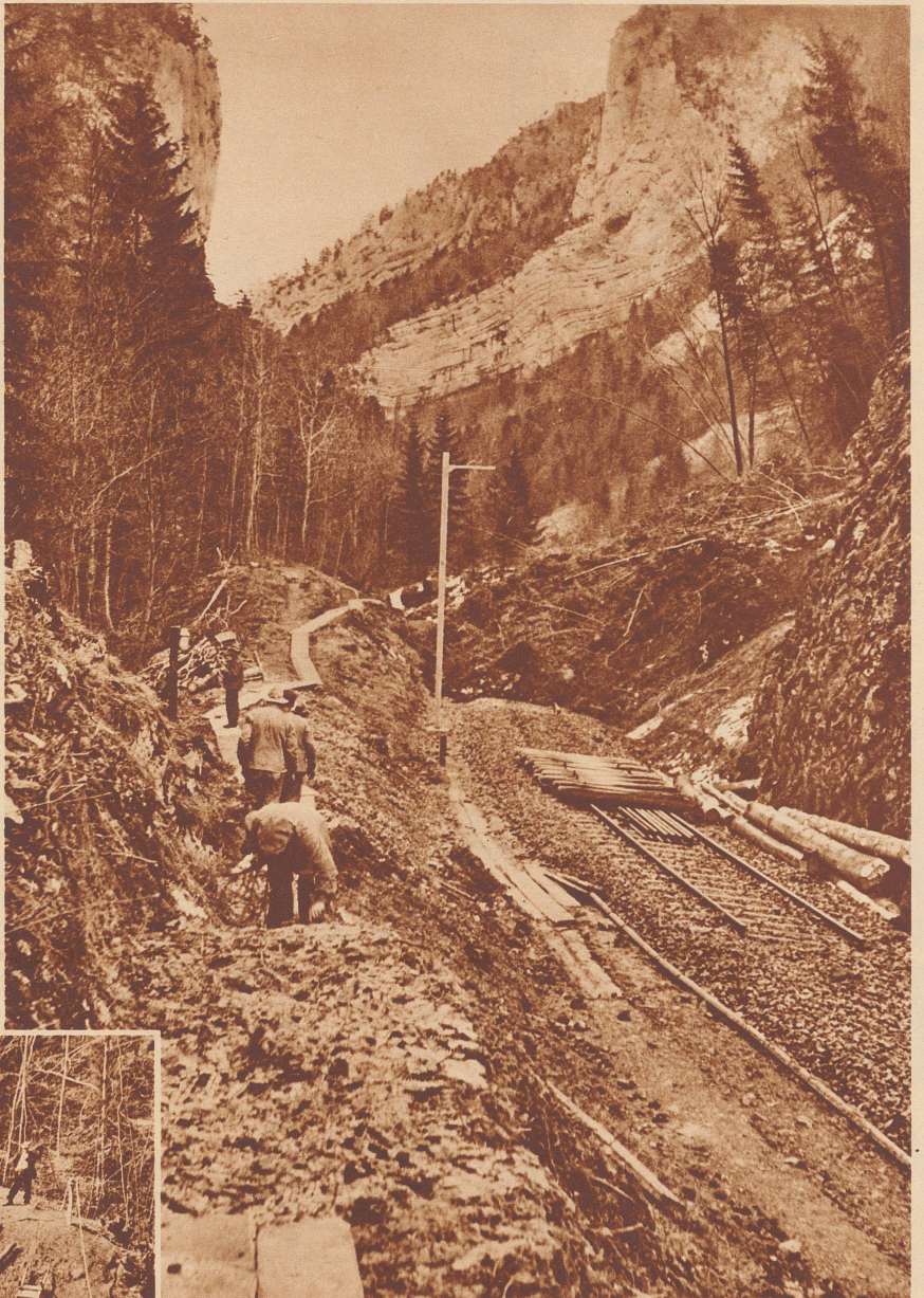
Blick in die enge Klus von Court mit einem Teil der Verheerungen des Erdrutsches. Auf eine Länge von 300 Meter ist das Bahntrasse mit mächtigen Felsblöcken, Schutt und Bäumen meterhoch verschüttet. Wo das noch möglich war, wurde in aller Eile das Geleise abmontiert.
