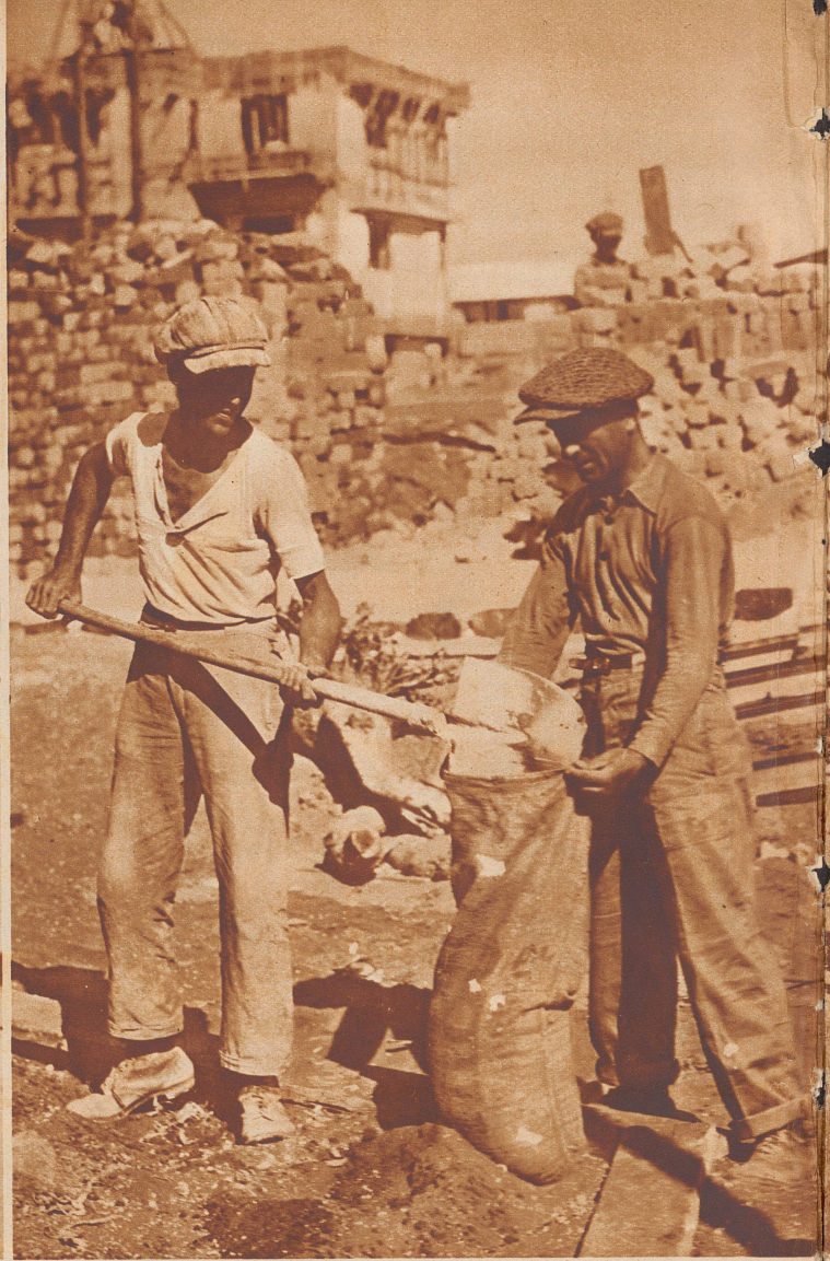
Der erste Schritt zu wahrer Berufsumsichtung. Der junge Mann, der die Schaufel führt, war — Buchhändler. Er ist drauf und dran, ein Bauarbeiter zu werden. Mit dem Säckefüllen und Säckeschleppen fängt es an. Die Ueberwindung der Scheu vor körperlicher Anstrengung fällt nicht leicht, der menschliche Organismus gewöhnt sich nur langsam und unter Schwierigkeiten an den plötzlichen und radikalen Wechsel seiner Lebensbedingungen. Es gehört jener Wille dazu, der aus der Erkenntnis des Notwendigen entspringt.
