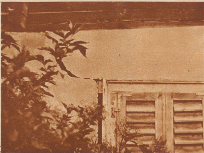
Der Schiefer, auf dem das Dorf abrutscht, ist nicht so glatt wie eine Schieferwandtafel. Da geht die Fahrt nicht immer ohne Risse und Sprünge in den Hausmauern ab. Aufnahmen Staub
