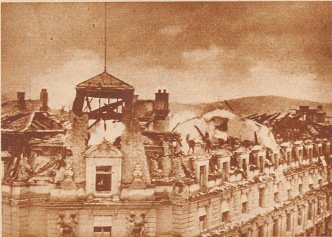
Am 1. Mai 1932 brach im Gebäude der Obertelegraphendirektion an der Speichergasse in Bern ein Brand aus, durch den der vierte Stock, der Estrich und das Dach vollständig zerstört wurden
