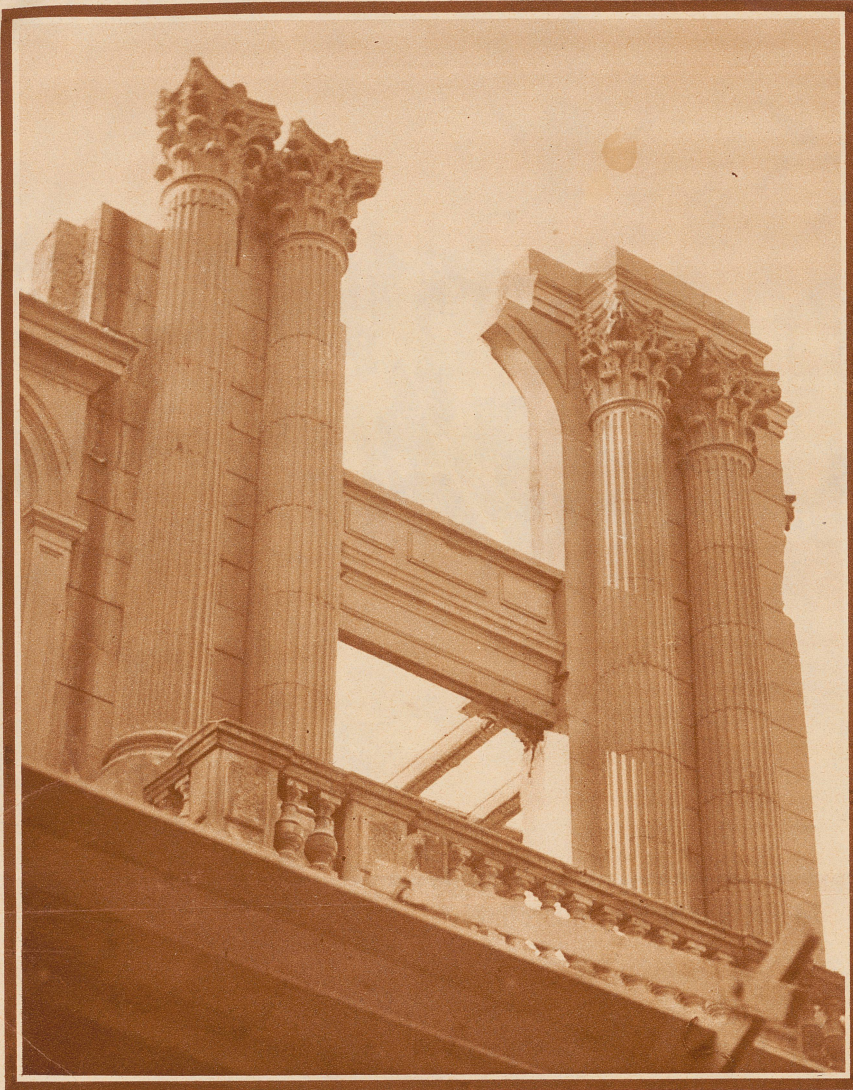
Säulen fallen. Am Bahnhofplatz in Zürich wurde vor 50 Jahren ein für die damalige Zeit monumentaler Prachtsbau, das Hotel Victoria erstellt. Nun toben sich die Zerstörungswerkzeuge einer Abbruchfirma an dem Gebäude aus. Noch ragen einige griechische Säulen stolz in die Luft, aber in einigen Tagen wird das Hotel Victoria I. Ranges, in dem Hunderte von Berühmtheiten aus allen Ländern, Fürsten, Könige, Kardinäle und hohe Militärs logierten, vom Erdboden verschwunden sein Aufnahme Staub
