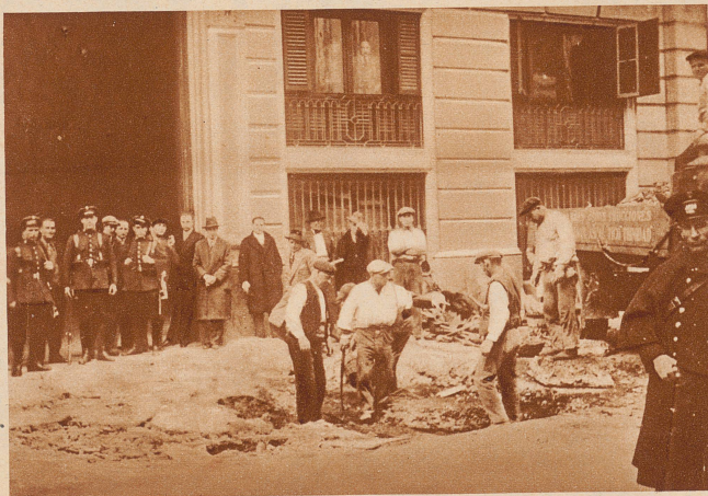
Vor dem Haupteingang der Polizei-Präfektur in Barcelona ist eine Bombe explodiert; der Schaden wird sofort von Arbeitern ausgebessert
