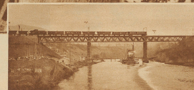
Blick auf die Baustelle von der alten hölzernen Straßenbrücke aus. Unmittelbar oberhalb der Bahnbrücke werden das Stauwehr und das Maschinenhaus erstellt. Unterhalb der Brücke (links im Bilde) ist der Bau der Wohnkolonie für das Betriebspersonal im Gange. Phot. Melli
