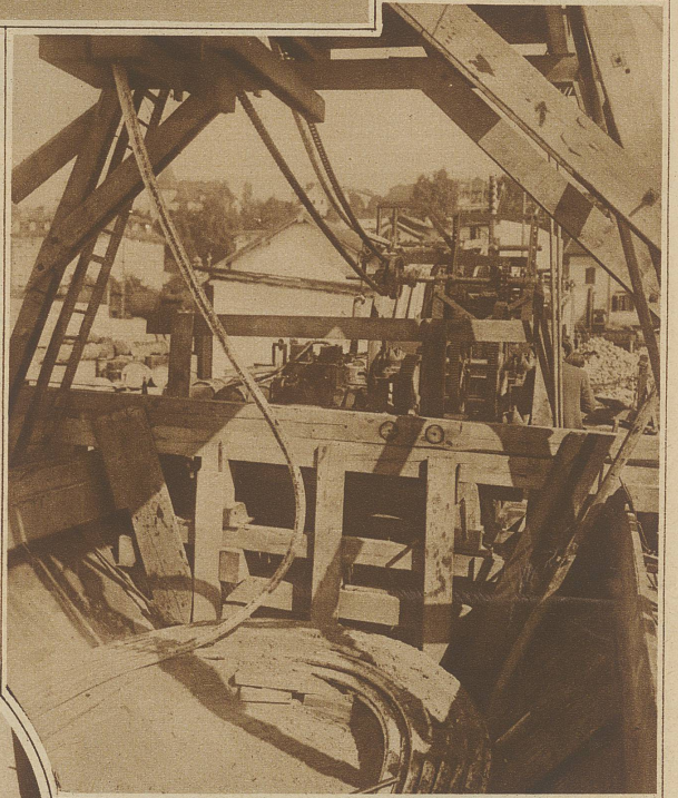
Rechts: Abwicklung des Kabels im Schiff
