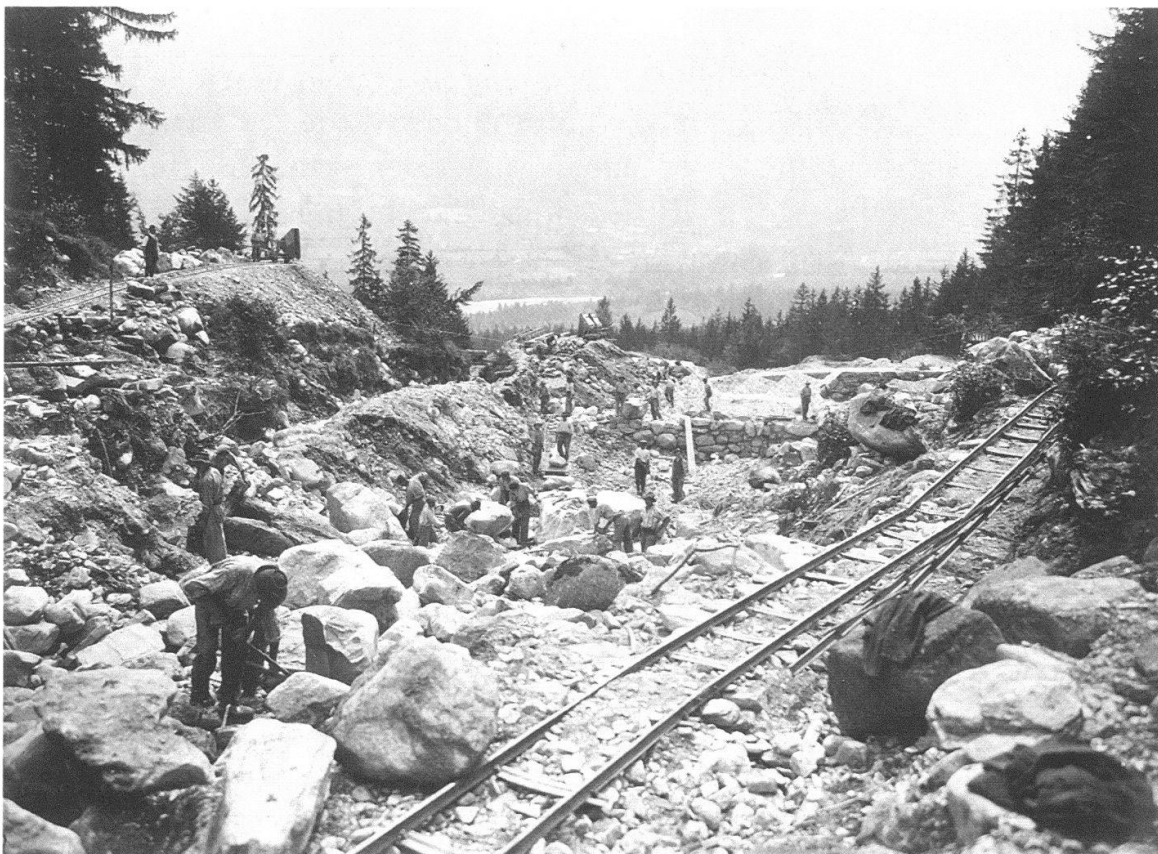
Abb. 1 Baustelle am Unterlauf des Heitibachs in Wengi bei Frutigen um 1913. Der Einsatz von Maschinen war nicht überall möglich, deshalb kam oft menschliche Arbeitskraft zum Zug.
