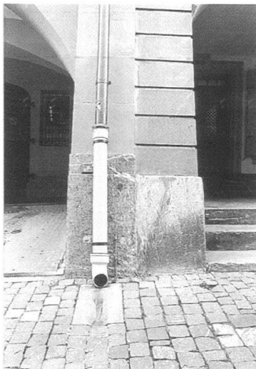
Pflasterung Junkerngasse/ Kreuzgasse: Detail der Neupflasterung mit einer der vier wiederher- gestellten offenen Dach- entwässerungen der Schatt- seite der Junkerngasse.
