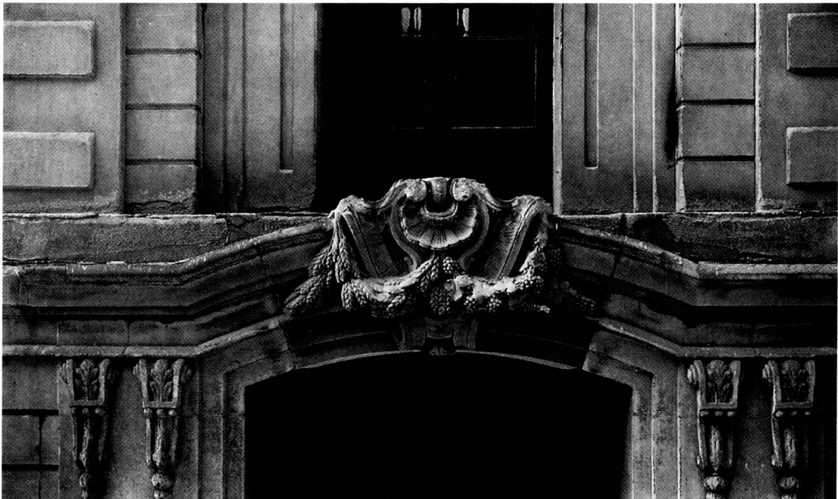
Abb. 4: Oben: Schlussstein der ehemaligen Mittelarkade der Ankenwaag, um 1760, vor der Renovation. Konservative Louis XV-Agraffe mit Reb- und Korngirlande als Hinweis auf die damaligen Hauptinhalte Wein und Korn. – Unten: Schlussstein der Mittelarkade von Heblers Erweiterungsbau 1861, symmetrische Muschelagraffe in enger stilistischer Anlehnung an jene der Ankenwaag. Photographie: M. Hesse, Kunstdenkmäler des Kantons Bern.
