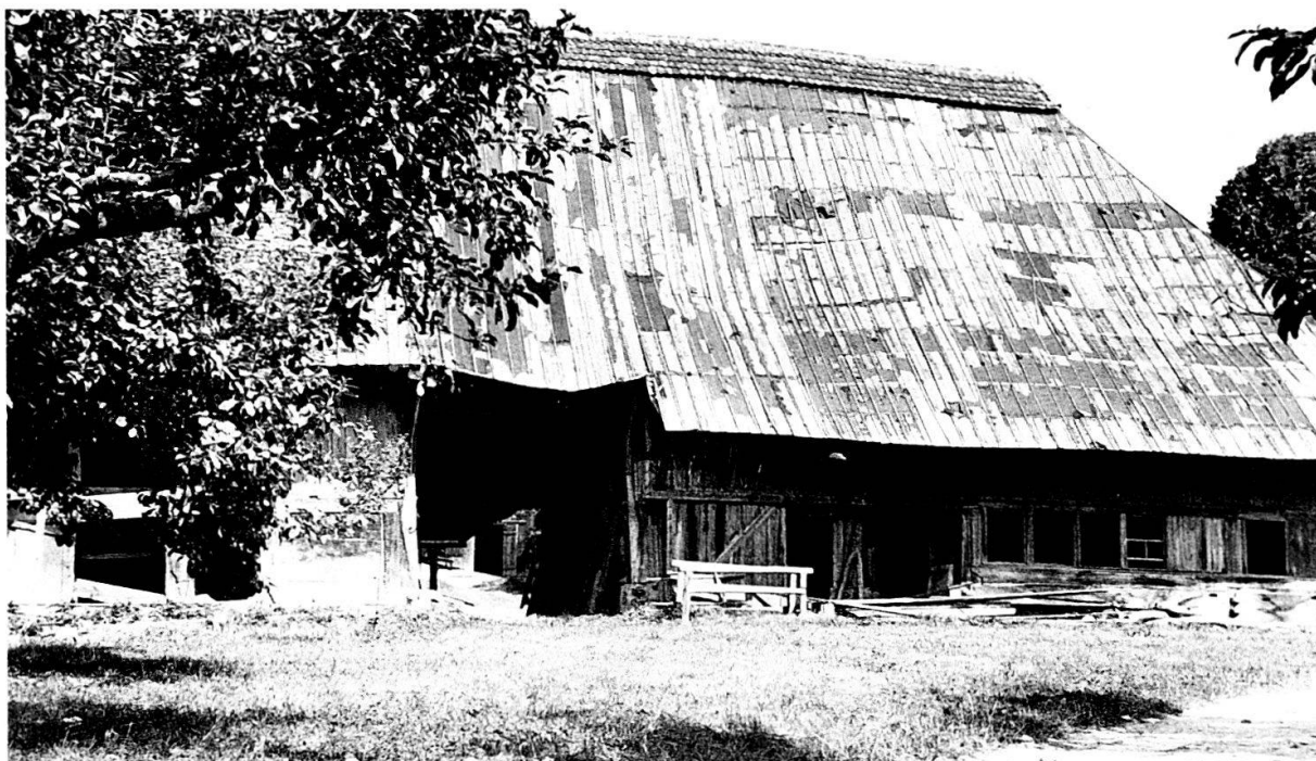
Das Bauernmuseum «Althus» mit einem Notdach aus Dachpappe, welches im Winter 1943/44 angebracht worden ist.
