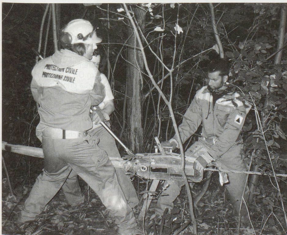
Unwetterschäden werden behoben.
