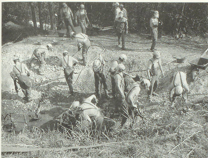
Der künstliche Weiher aus Beton musste abgetragen werden, um dem Hang wieder eine Stütze zu geben.
