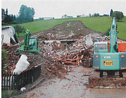
Komplett zerstörtes Haus in Lutzenberg: Die Bewohner hatten keine Chance.
