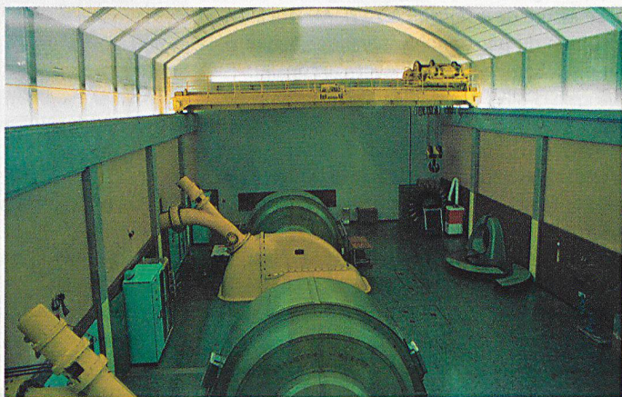
Les deux turbines produisent 143 millions de kWh par année.
