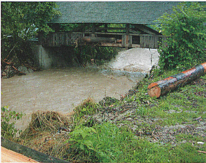
Der Baumstamm in der Mitte der Brücke demonstriert die Wucht des Wassers.
