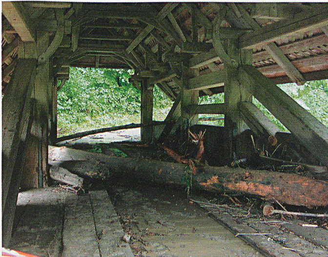
Wie ein Geschoss durchschlug der Baumstamm das massive Brückengeländer.
