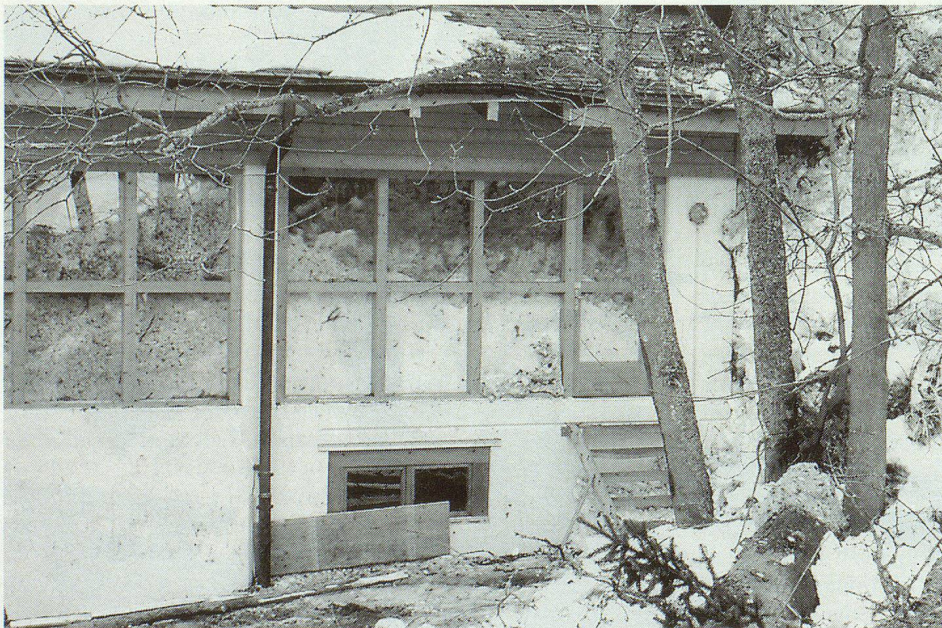
Solche Verwüstungen verunmöglichten es den Bahnbetreibern, die Luftseilbahn Wengen-Männlichen – sie stellt ein wichtiges Verkehrsmittel auf den Männlichen dar – innert nützlicher Frist wieder in Betrieb zu nehmen.
