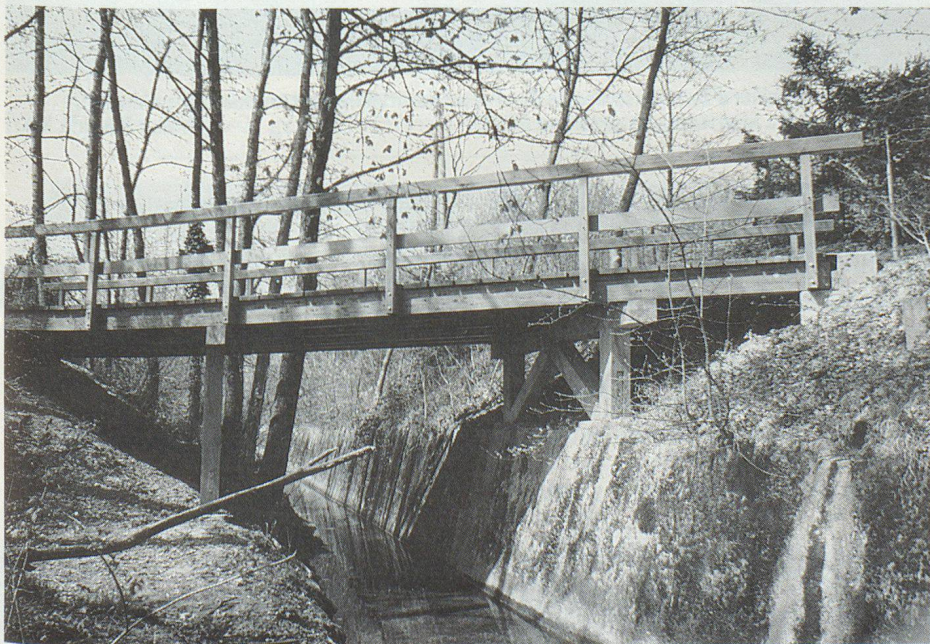
Le pont sur le Lavasson: «De la belle ouvrage» comme on dit dans le canton.
